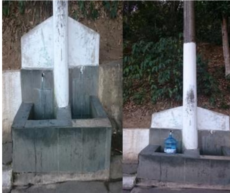
Figura 5.3 - Ponto de captação da nascente do Bairro Vila Ursulino.
