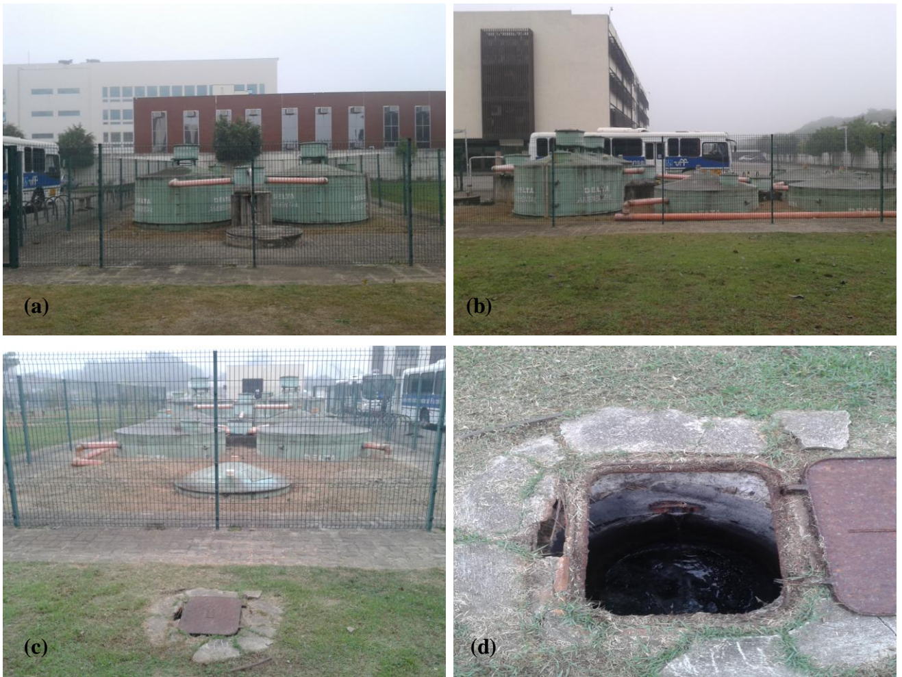
Figura 9. Estação de Tratamento de Efluentes (ETE) da UFF – Campus Atterrado . (a) Vista frontal da ETE, com destaque para o poço de recalque e para os dois reatores UASB; (b) Vista lateral da ETE; (c) Vista frontal da ETE, com destaque para os filtros anaeróbios de fluxo ascendente, a caixa de passagem e a ligação com a rede coletora; (d) Detalhe da saída do efluente da ETE.
